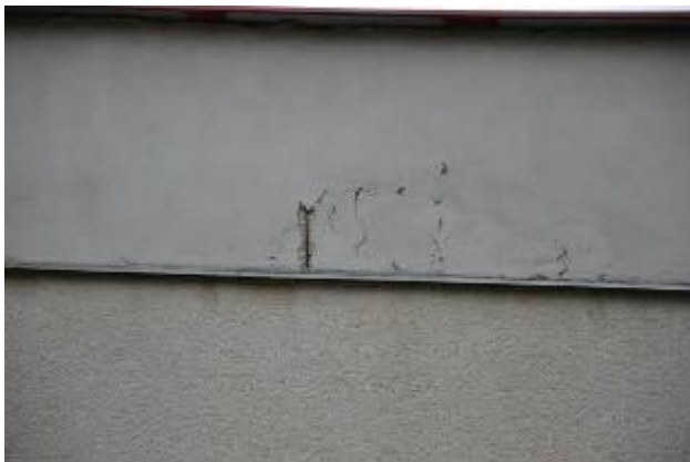
Detajl poškodbe na gredi na V fasadi ↑
