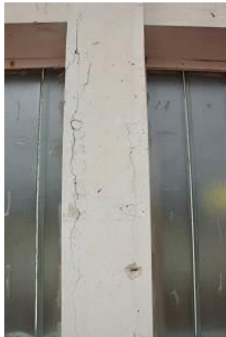
Detajl poškodbe stebra na J fasadi telovadnice ↑
