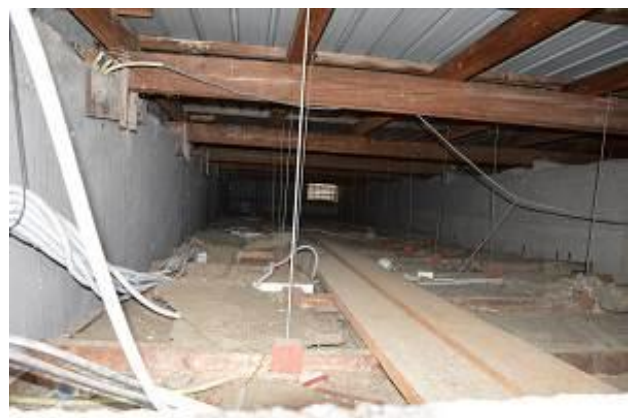
Notranjost strešne konstrukcije telovadnice ↑ (vešala obremenjujejo tudi špirovce)- nevarni dostopi popravil luči !! → TERMOIZOLACIJA LE 7 CM NEUSTREZNO IN POTRATNO → NEUSTREZNO ZA ENERGETSKO CONO !
