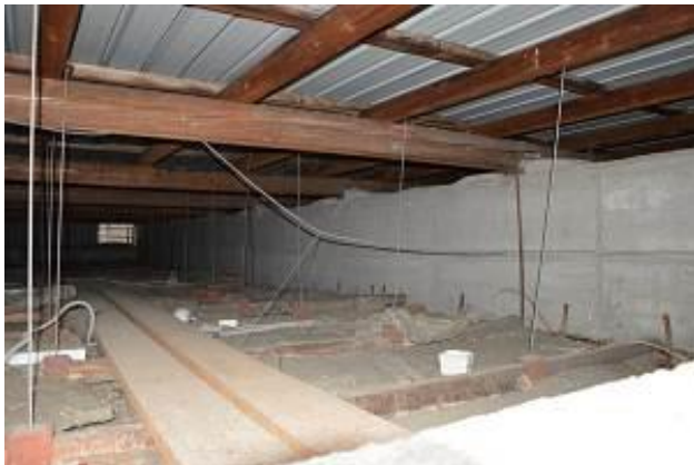
Notranjost strešne konstrukcije telovadnice ↑ (vešala obremenjujejo tudi špirovce)
