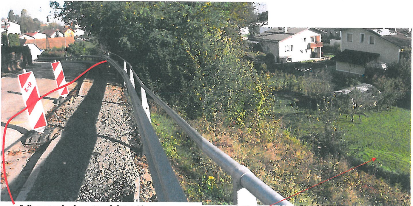
Odlomni rob ob cesti v dolžini 18m
