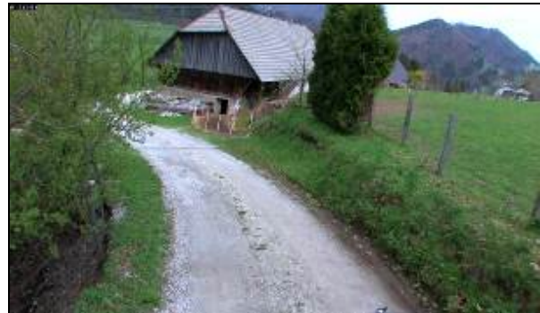
Slika 4.13: Delno poškodovano vozišče (primer 2)
