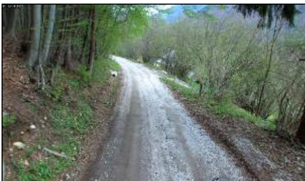
Slika 4.14: Poškodovano vozišče (primer 1)
