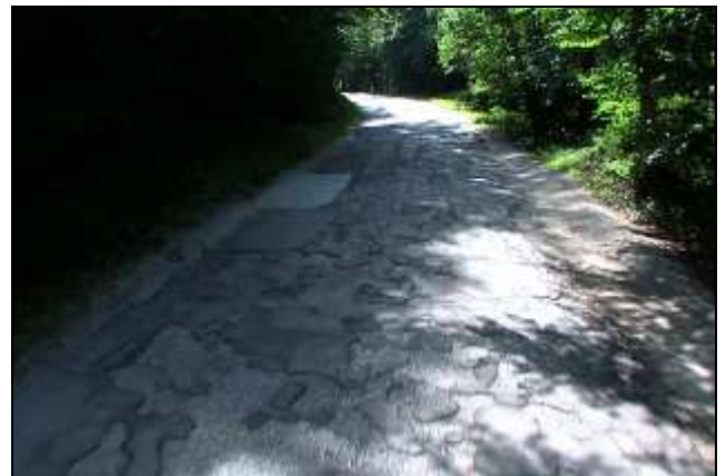
Slika 4.5: Obraba - Luščenje obrabne plasti
