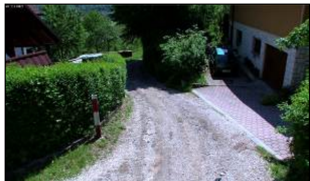
Slika 4.15: Poškodovano vozišče (primer 2)
