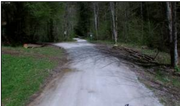
Slika 4.12: Delno poškodovano vozišče (primer 1)
