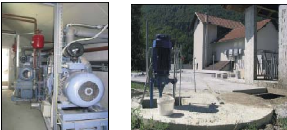
Slika 11: Prvi primer izrabe bioplina v namene proizvodnje električne energije v Sloveniji; sistem SPTE ter črpalni jašek in fermentorja
