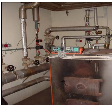
Slika 23: Kotel v kotlovnici Apače 43
