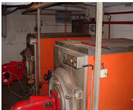
Slika 27: Kotlovnica Simoničev breg
